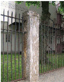
Figura 15. La evidencia del movimiento de humedad a través del hormigón es evidente en forma de depósitos minerales en la superficie de este. La congelación y descongelación cíclica de la humedad atrapada y la corrosión de las armaduras también han contribuido al deterioro de la columna de hormigón en esta cerca en Crocker Field en Fitchburg, Massachusetts, diseñada por los Hermanos Olmsted.
