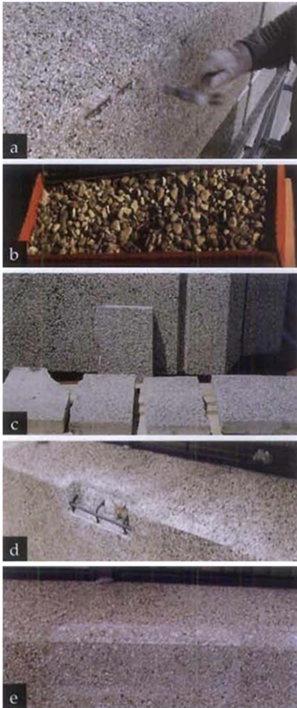
Figura 18. (a) El hormigón prefabricado con árido visto se hace sonar con un martillo para detectar áreas de deterioro. La corrosión de las barras de acero de refuerzo ha provocado el desprendimiento del hormigón adyacente. (b) Las muestras de áridos considerados para el uso en el hormigón de reparación se comparan con los materiales de hormigón originales en términos de tamaño, color, textura y reflectancia. (c) Se fabrican varios paneles de muestra utilizando el diseño de mezcla de reparación de hormigón seleccionado para comparar con el original del edificio, y el diseño de mezcla se ajusta en base a la revisión de las muestras. (d) Después de eliminar la zona afectada, la superficie de hormigón se prepara para la instalación de un parche. (e) Antes de la colocación del hormigón, se aplica un agente retardante a la cara interior del encofrado para retrasar el curado en la superficie. Una vez que el hormigón está parcialmente curado, se retira el encofrado y la superficie del hormigón se frota para eliminar parte de la pasta y exponer el árido para que coincida con el acabado original.
