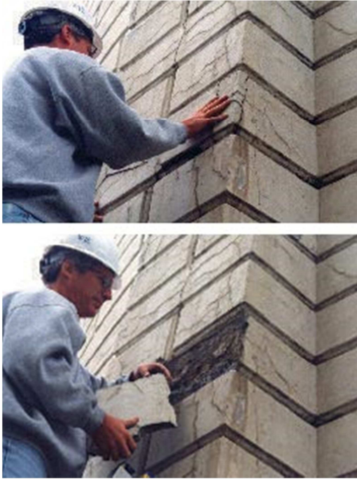
Figuras 14. Las capas de hormigón arquitectónico que se han desprendido de la superficie se retiraron de un tanque de agua histórico durante la investigación realizada para evaluar las condiciones existentes. Fotografías: Anita Washko, Wiss, Janney, Elstner Associates, Inc.
